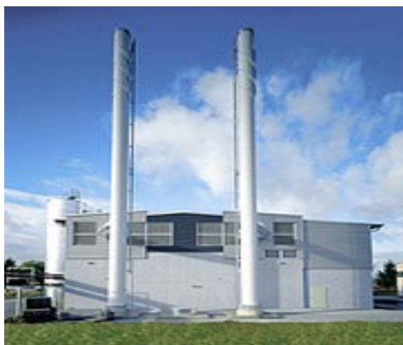
Kraft-Wärme-Kopplung: Blockheizkraftwerk (BHKW) in Schwäbisch Hall
